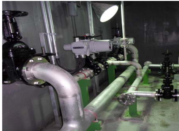
펌프 및 배관설비 (광동)
