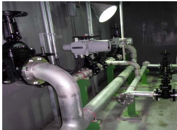
펌프 및 배관설비 (광동)
